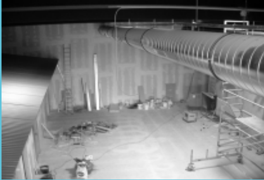
Blick von den Technikräumen aus in die große Veranstaltungshalle.
